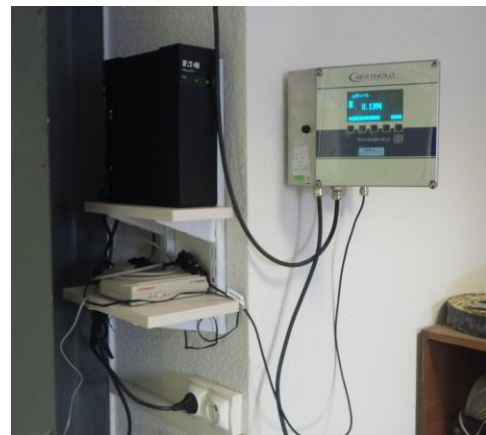
Electronique d'acquisition et de traitement du signal mesuré par la sonde - Modem pour la transmission des données
